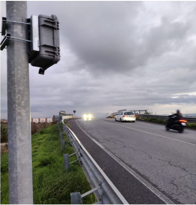
Figura 3.1 – Esempio di installazione di radar
