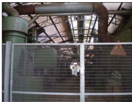
Fig. 7 – Vista interna impiantistica da rimuovere
